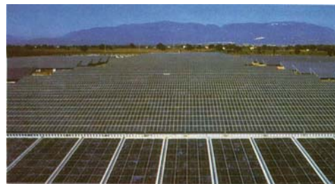
Centrale solare fotovoltaica
